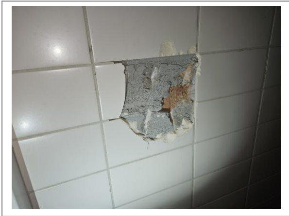
Destructief onderzoek wandtegels toiletgroep
