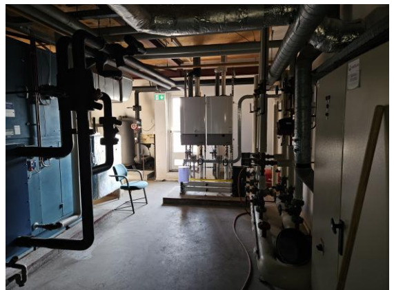
CV-ruimte 3 e verdieping
