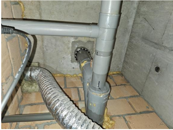
PVC afvoerleidingen toiletten
