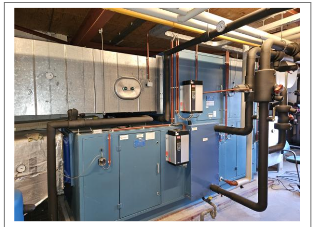
Luchtbehandelingskast in CV-ruimte
