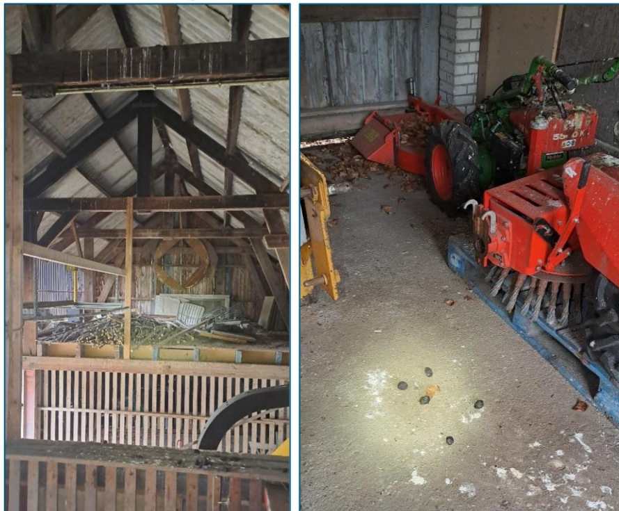
Figuur 5-1 Een impressie van sporen van kerkuil (braakballen en krijstrepen) aangetroffen in gebouw 106. Foto's RHDHV, 2024.
