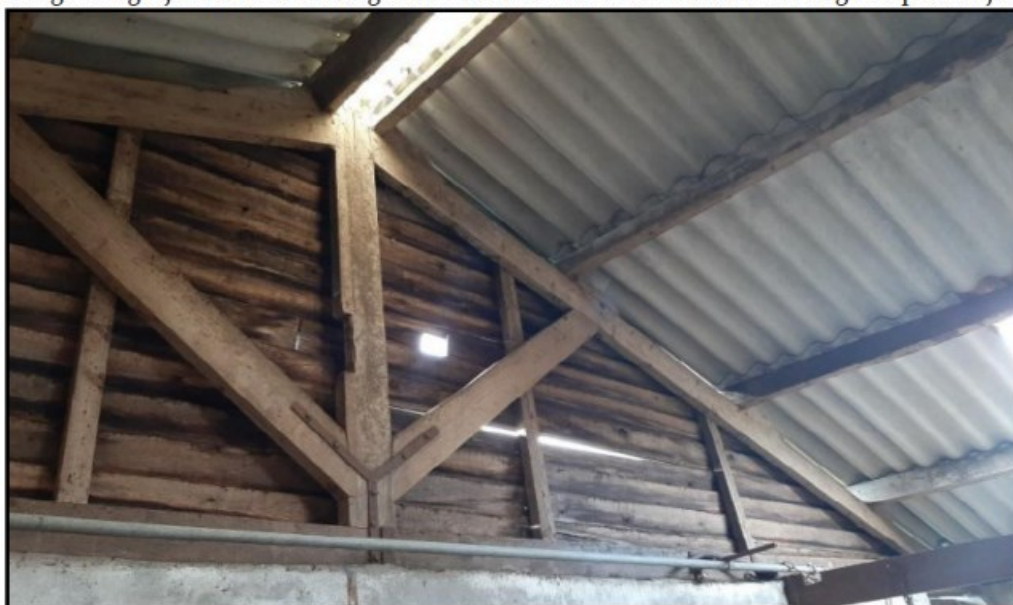
Figuur 4 de gevelbetimmering van opstal B is ongeschikt voor vleermuis verblijfplaatsen, vanwege de afwezigheid van een binnenmuur.
