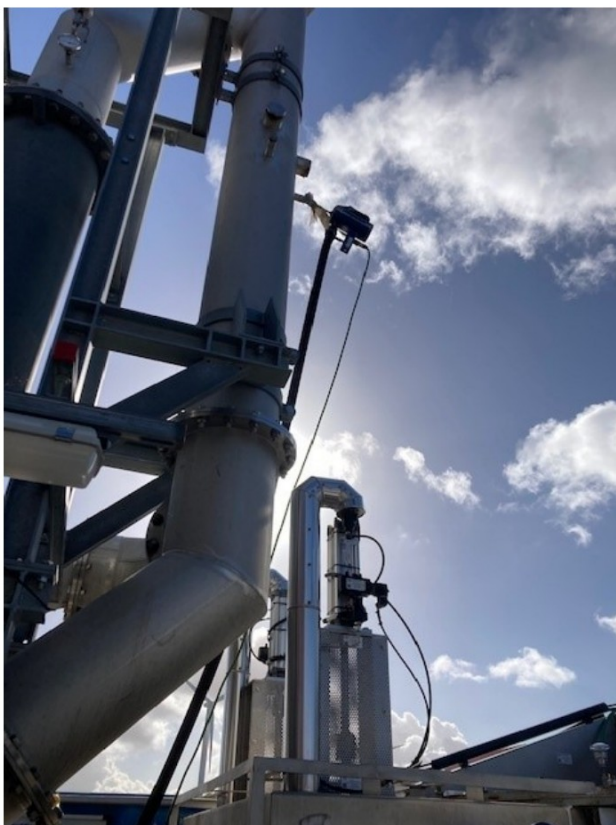
Foto 3.1. Meetlocatie in schoorsteen RTO.
