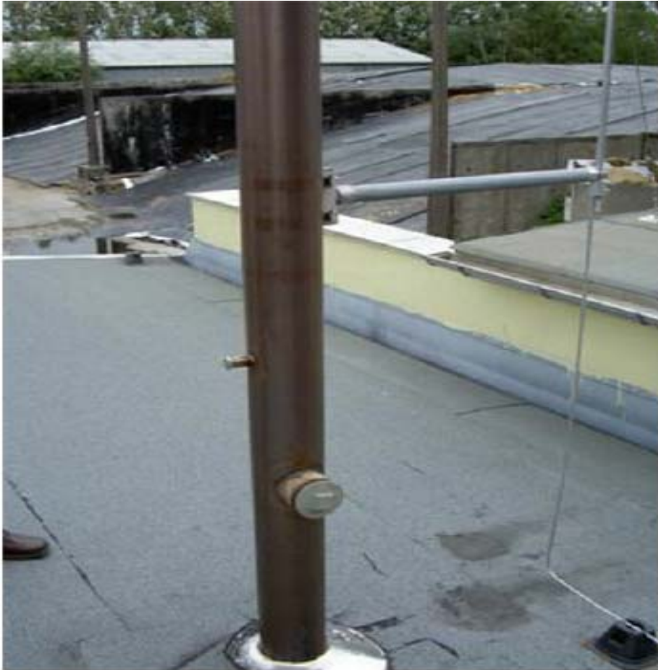
Abbildung 3: Messstelle am BHKW 1/1
