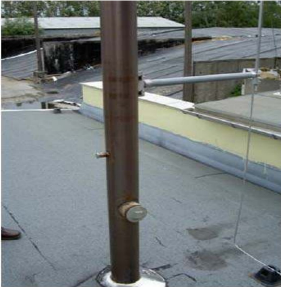
Abbildung 3: Messstelle am BHKW 1/1
