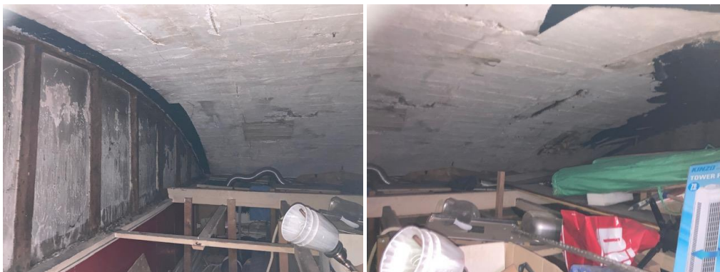
Bijzonderheden: raam- en deursparing in subconstructie tussenhuisnummers 26 en 28. Beschadigingen niet dragende boogconstructie huisnummer 28. Doorkijk naar bovenliggende constructie laat ter plekke de intactheid zien, zie foto's.
