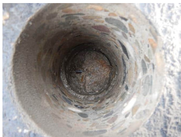
Foto 6.46: Boorgat in-situ betondek oostfase; holle ruimte onder in-situ betondek.
