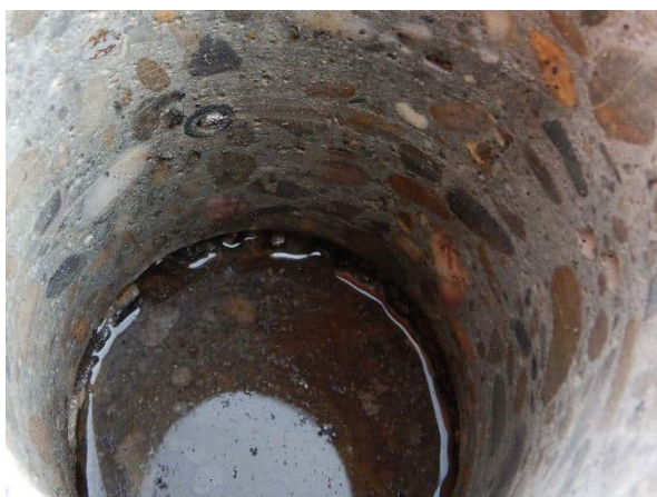
Foto 6.53: Boorgat in-situ betondek oostfase; holle ruimte onder in-situ betondek.
