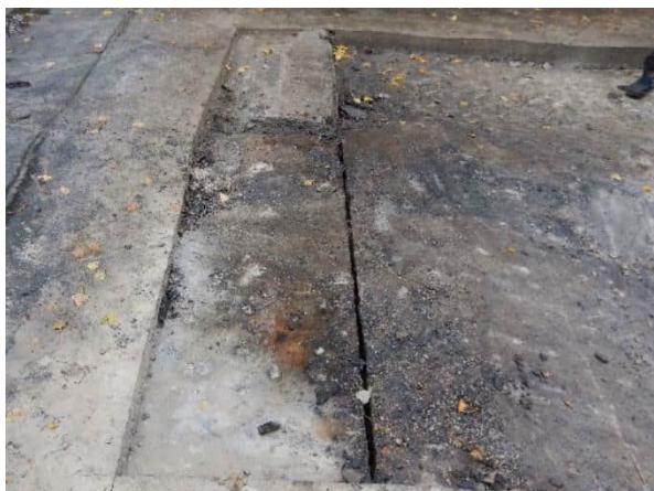
Foto 4.18: Dilatatie onderzoekslocatie O15.
