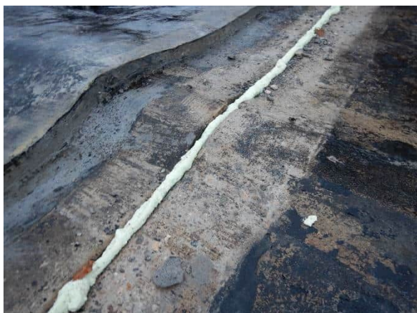
Foto 4.20: Dilatatie onderzoekslocatie O19.
