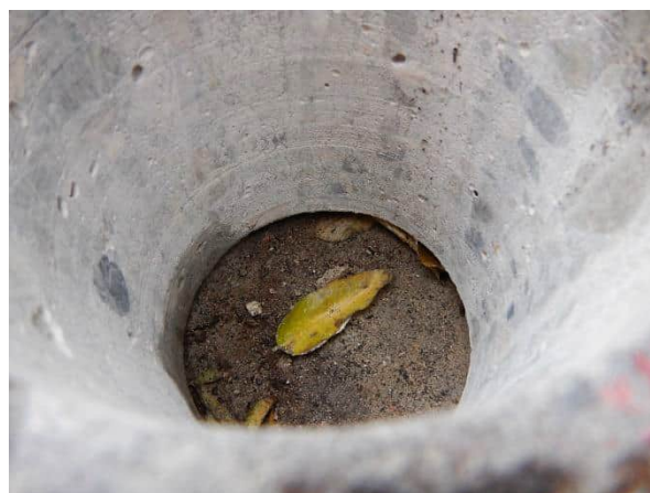
Foto 6.54: Boorgat prefab randbalk westfase; holle ruimte onder prefab randbalk.
