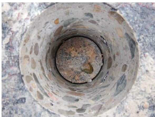
Foto 6.44: Boorgat in-situ betondek westfase.
