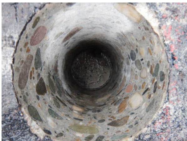
Foto 6.49: Boorgat in-situ betondek westfase.
