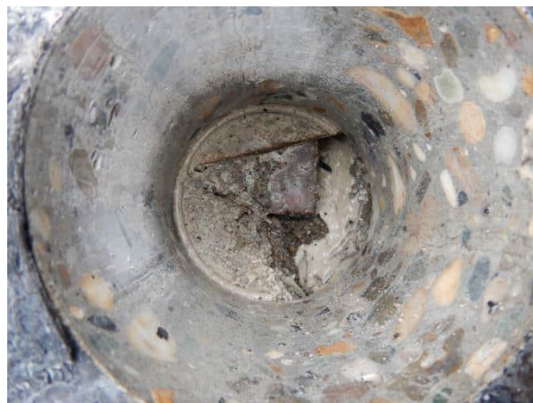
Foto 6.48: Boorgat prefab randbalk oostfase; houten klos zichtbaar.
