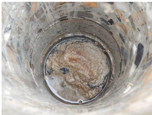
Foto 6.56: Boorgat in-situ betondek oostfase; holle ruimte onder stampbeton.
