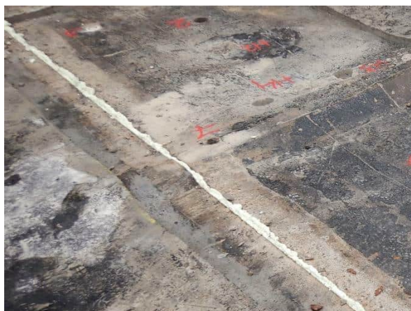
Foto 4.21: Dilatatie onderzoekslocatie O20.
