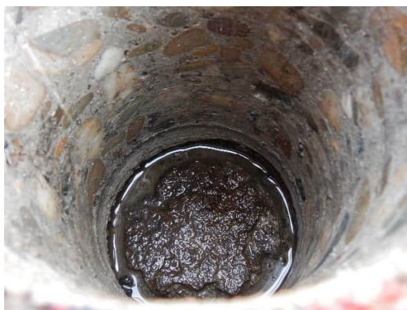
Foto 6.52: Boorgat in-situ betondek westfase.
