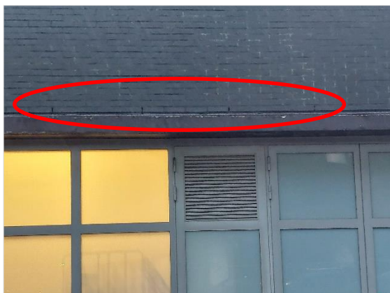
Figuur 4.1 Open stootvoegen in gebouw ten noorden van het Delftsplein.
