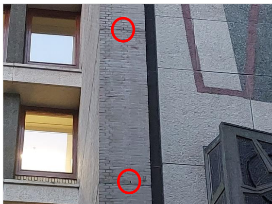
Figuur 4.2 Open stootvoegen in gebouw ten oosten van het Delftsplein.
