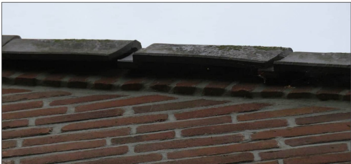
Afb 9: Kantpannen ter plaatse van metselwerk. Opening groot genoeg om gebruikt te worden als in- en uitvliegopening
