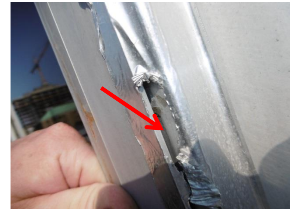
Foto 18: De afdichting tussen de kozijnen en het aluminium zetwerk ontbreekt op diverse posities..
