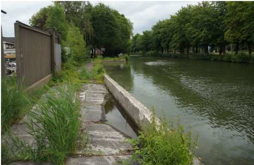
Figuur 16: loswal ter plaatse van sectie G
