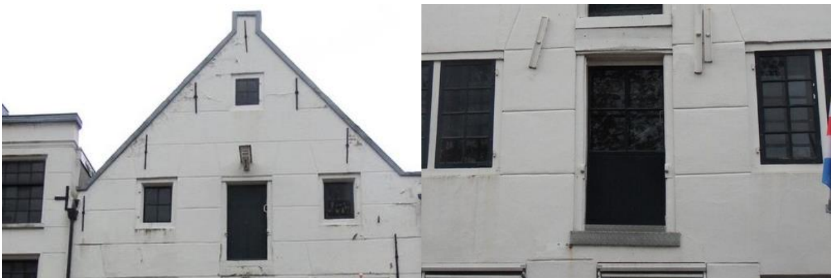
Afb. 24: Verankeringen. Links de tuitgevel van huisnummer 58 met eenvoudige schieters. Rechts extra in kleur van de gevel mee geschilderde ankers uit profielijzer.
