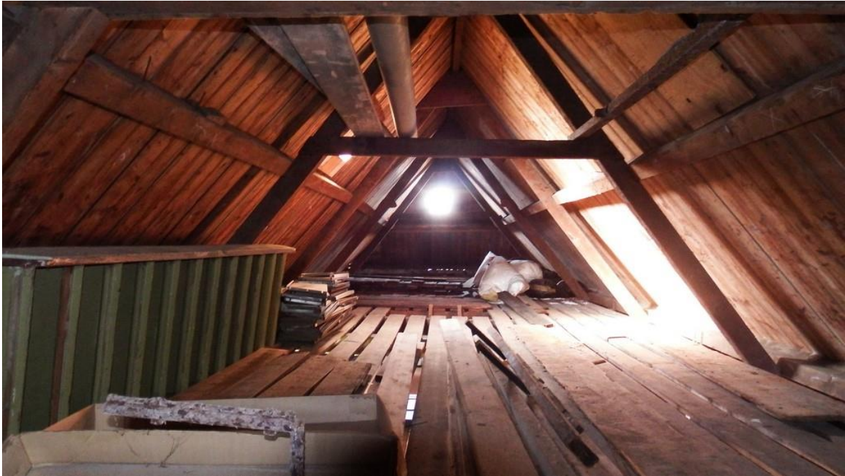
Afb. 4: Vliering van huisnummer 58 gezien naar de achtergevel met de aangebrachte gordingen op A-spanten.
