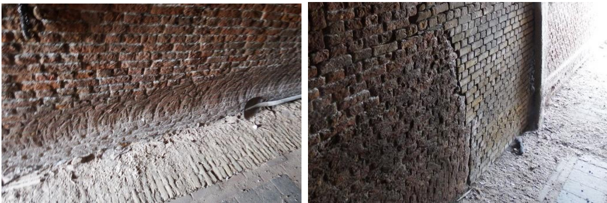
Afb. 33: Beschadigingen door het rollen van tonnen (links) en dichtzetting van een opening naar het souterrain van huisnummer 58 (rechts).
