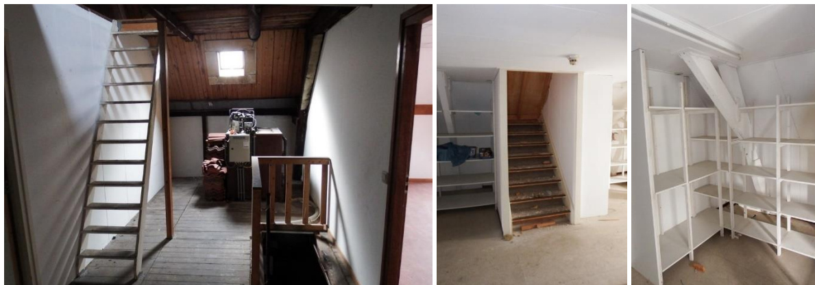
Afb. 40: Huisnummer 57. Links de overloop waarin de dakconstructie zichtbaar is, in het midden de dichtgezette doorgang met trap naar de rechter belending en rechts de stijl van een juk zonder blokkeel en drukschoor.
