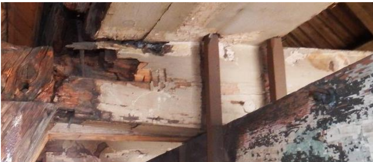
Afb. 13: Gehakt merk III (beschadigd) op de voorzijde van de dekbalk in de hergebruikte jukken van huisnummer 59.
