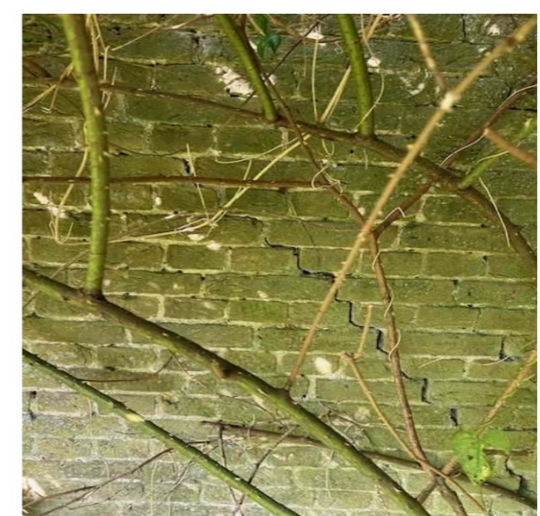
buitengevel kelder tpv nieuw raam
