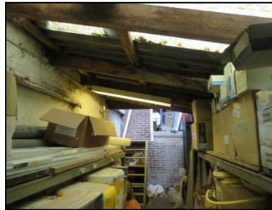
Figuur 7. Aanbouw met dak van asbest golfplaten.
