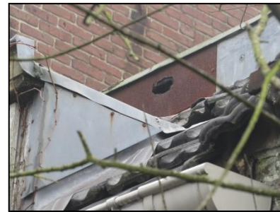
Figuur 11. Dak met gat in lijst gezien vanaf de achterzijde, kijkrichting naar het noordoosten.
