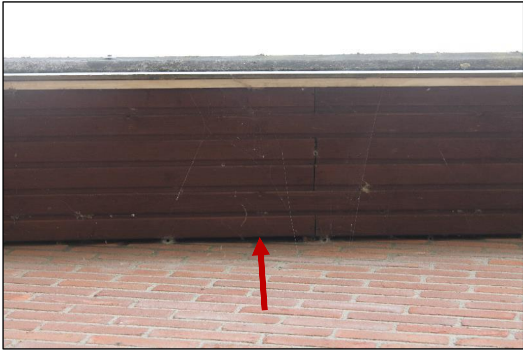
Figuur 3 Aan de loods zijn openingen aangetroffen in de vorm van kierende daklijsten. Deze openingen kunnen vleermuizen ruimte verschaffen voor eventuele verblijfplaatsen in de dakruimte of in de spouw. Ten aanzien van vleermuizen dient aanvullend onderzoek uitgevoerd te worden om de aan- of afwezigheid vast te kunnen stellen.
