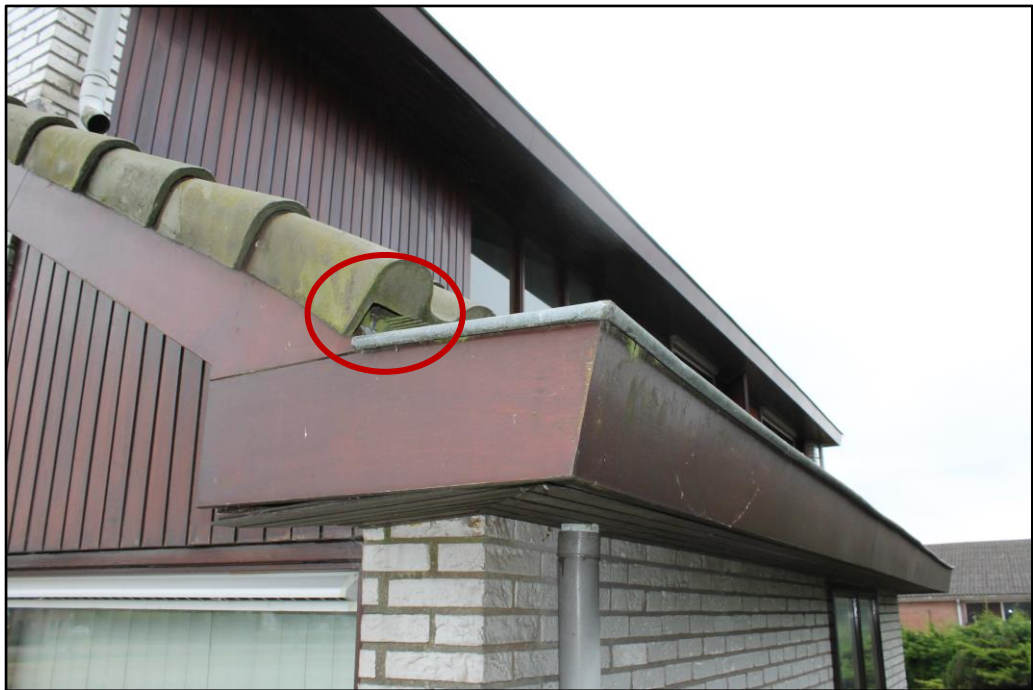
Figuur 4 Aanwezig vogelschroot onder de dakpannen van de woning.
