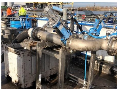
Koppelpunt op loskade
