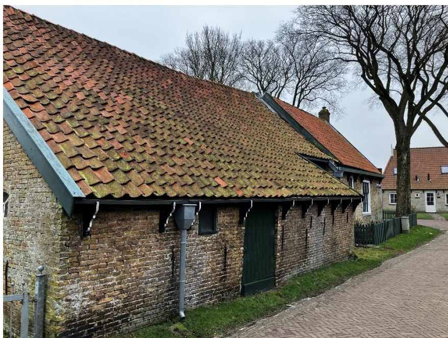
Dakgoten linker gevel
