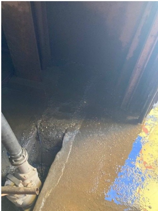
Foto 2-1 Vml. goot binnenzijde ERI-gebouw
