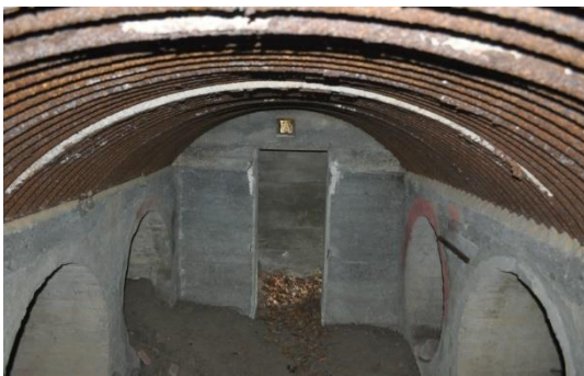
▲ Het interieur van de schuilplaats, let op het 'Wellblech' dak van het type 'Heinrich', de buizen die in het verlengde van elkaar geplaatst zijn en de vierkante opening boven de toegang. Foto Leo van Midden 2013
