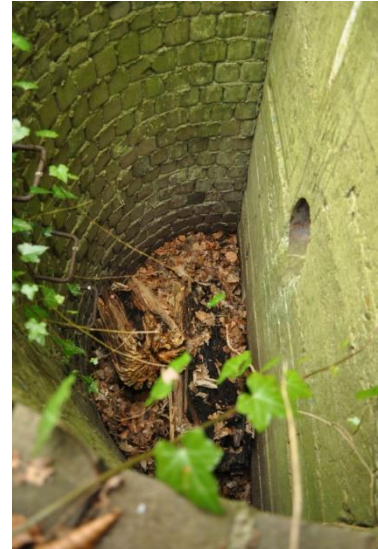
► De luchtafvoer van de kachel aan de noordzijde van de bunker wordt beschermd door een gemetselde halfronde muur. Foto Leo van Midden 2020
