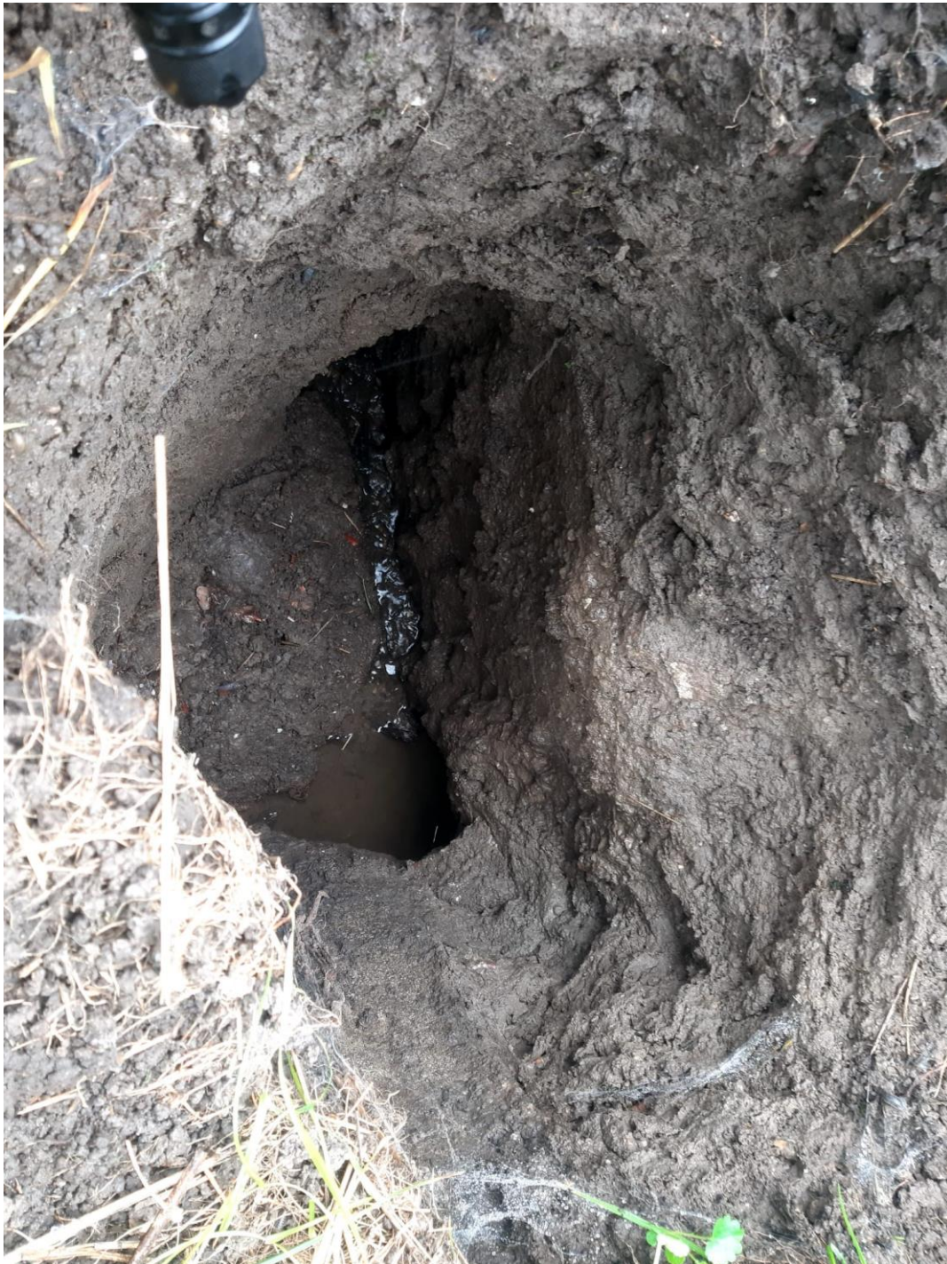
Diverse ontstane sinkholes en verzakkingen op het molenerf
