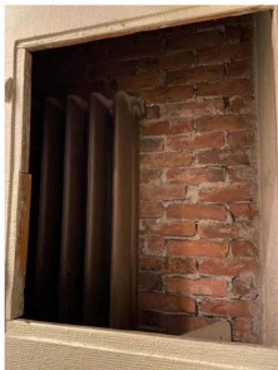
AFBEELDING 52, LEDENRADIATOR TUSSEN GARDEROBE EN HALL
