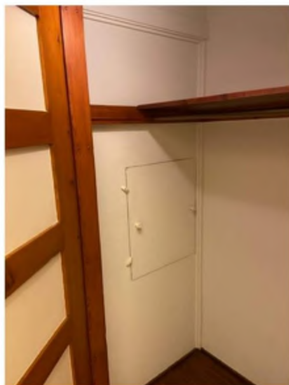
AFBEELDING 51, ASBEST LUIKJE NAAR RADIATORKAST
