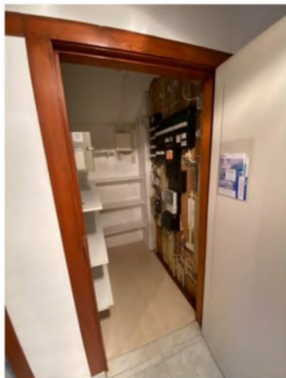
AFBEELDING 40, KASTRUIMTE KEUKEN MET METEROPSTELLING
