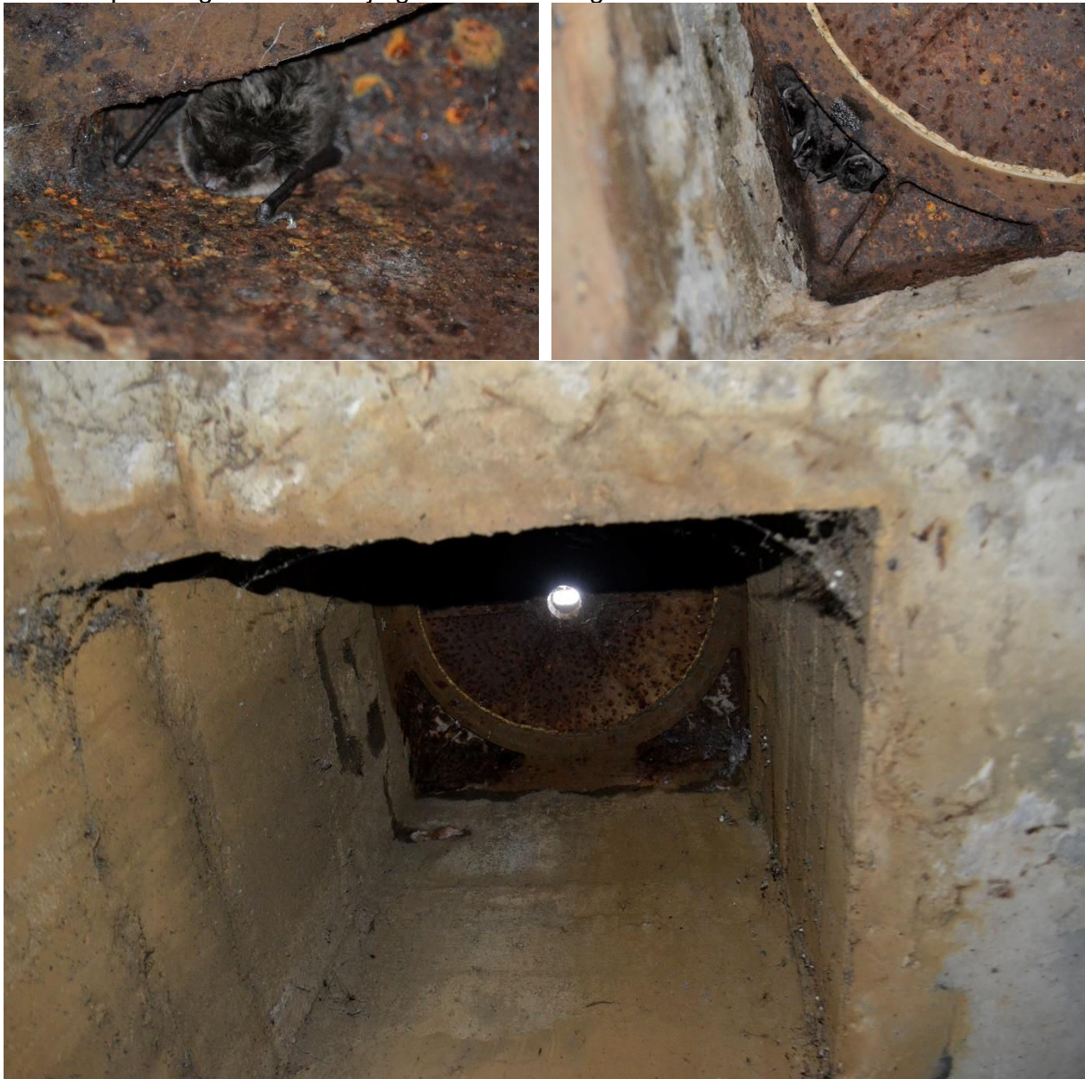
Figuur 3.2 Watervleermuizen hangend in straatkolk.
