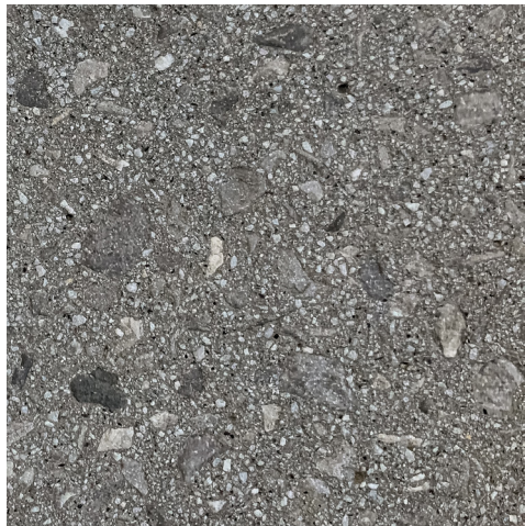
gevelbekleding penanten uitgewassen / gezandstraald beton
