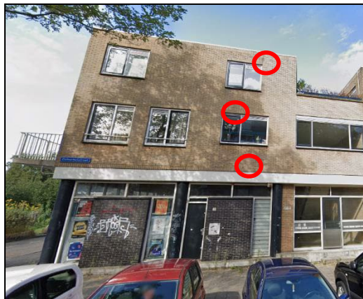
Figuur 6. Bebouwing ter hoogte van de Zomerhofstraat 9. Enkele open stootvoegen zijn ter illustratie aangegeven met een rode cirkel.
