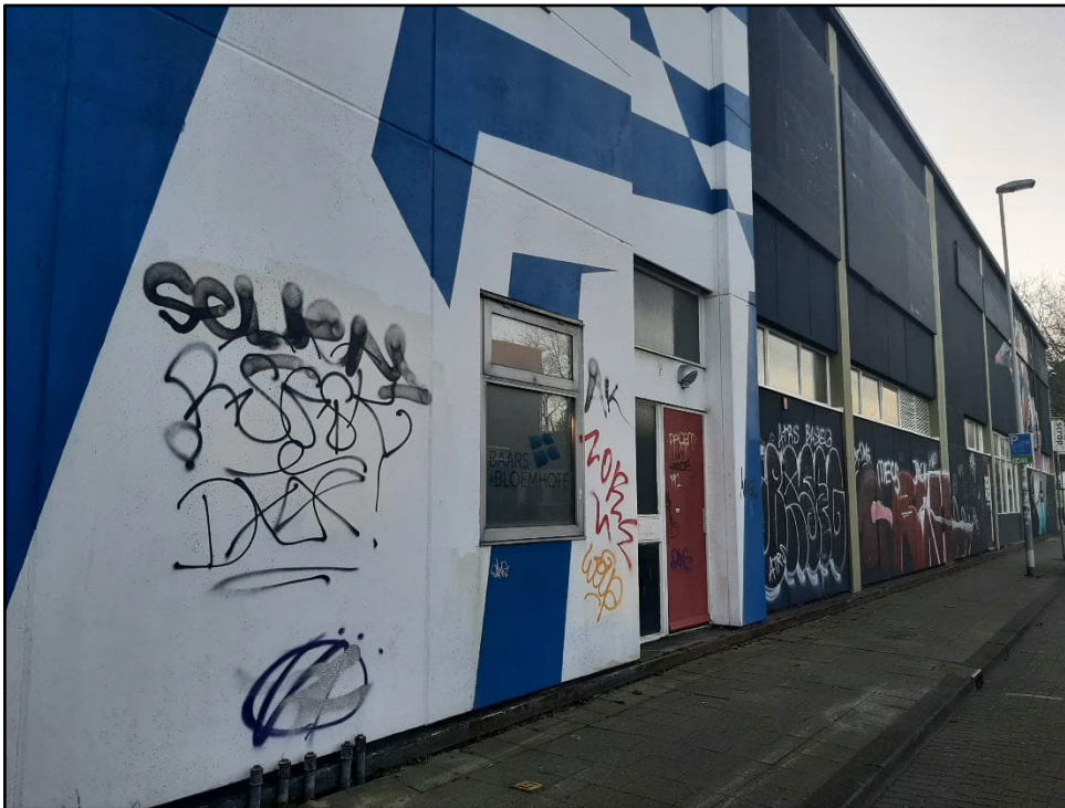
Figuur 5. De zijgevel van de projectlocatie aan de Schoterbosstraat. Zichtbaar is de graffiti.
