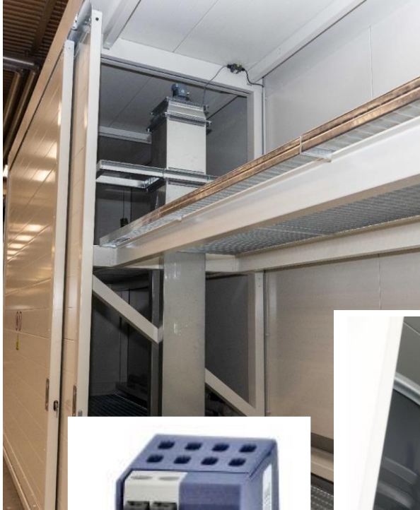
← Warmelucht recirculatie systeem
