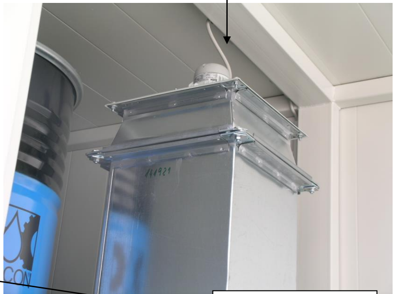
Instelbare thermostaat Jumo eTron T100 in schakelkast ingebouwd
