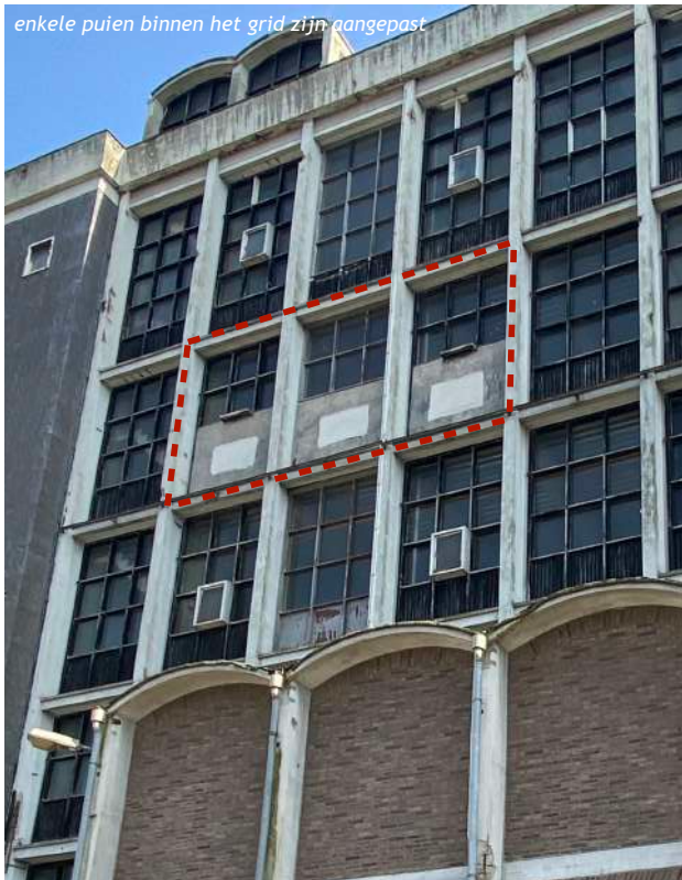
één gehele travee puin is voorzien van een nep-facade
