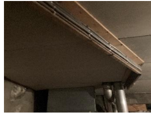
Foto voor bron Plafond (Plafond 01)
