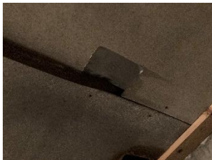
Foto voor bron Plafond (Plafond 01)
