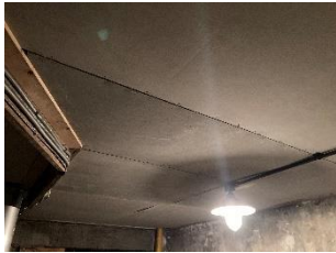
Foto voor bron Plafond (Plafond 01)
