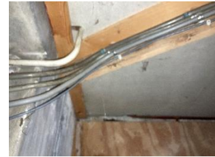
Foto voor bron Plafond (Plafond 01)
