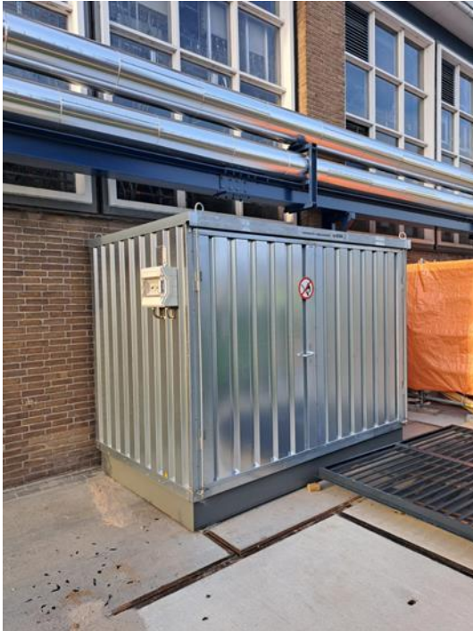
Fig. 2: NRB-container met rooster en opvangvoorziening, waarin de (verwarmde) IBC-container met 40% Ureum-oplossing wordt geplaatst, tegen de gevel van het Ketelhuis (T26).
