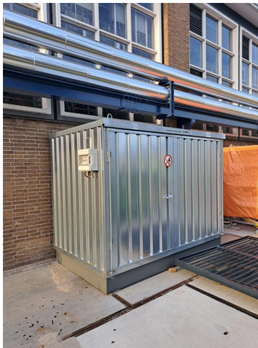
Fig.1: NRB-container met rooster en opvangvoorziening, waarin de IBC-container met 40% Ureum-oplossing wordt geplaatst, tegen de gevel van het Ketelhuis (T26).
