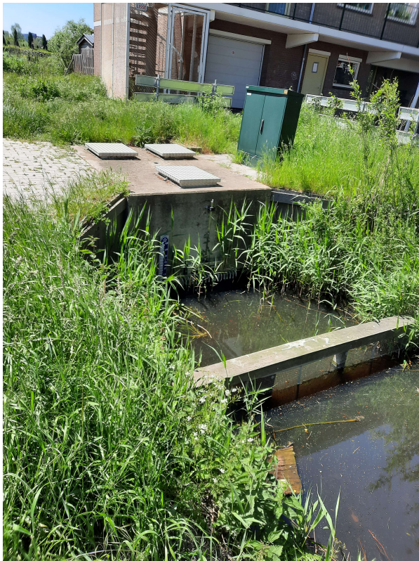
Foto 1. Huidige gemaal I
