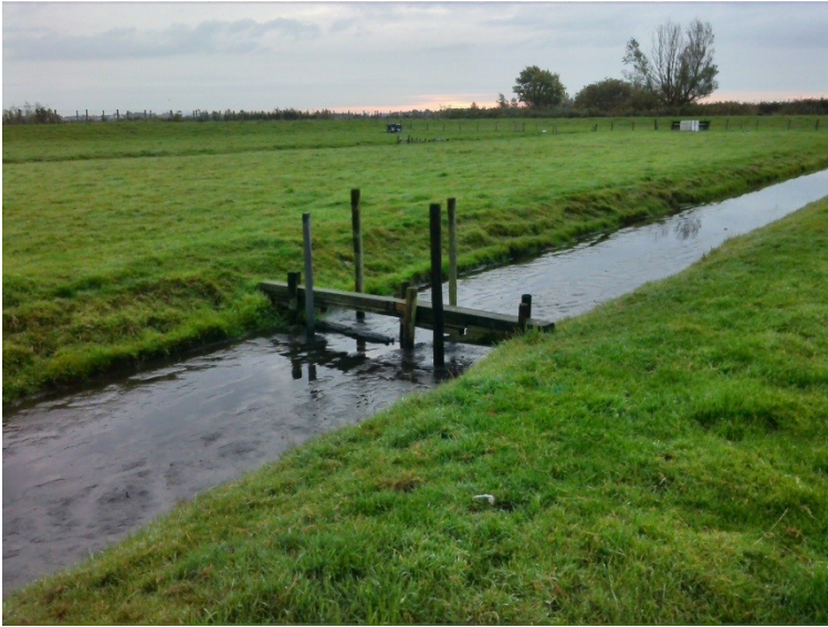
Figuur 3-4 Baggerachterstand watergang 074-058-00060-01, OR-3.30.02
