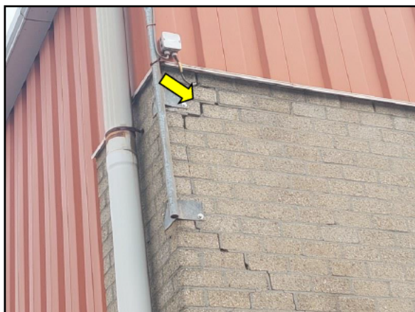
Figuur 10. Scheuren in buitenmuur die toegang verleent tot de spouwmuur.
