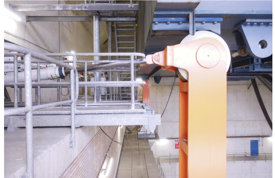
Detail van de bovenzijde van de opzetstelten die met een hydraulische pomp in beweging kunnen worden gezet wanneer de brug geopend dient te worden.
