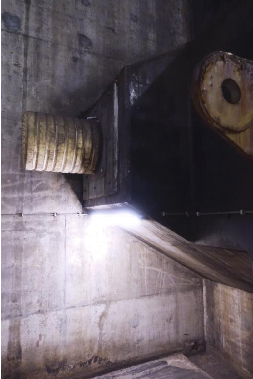
Aan de onderzijde van de open ruimte zijn per ruimte twee veren geplaatst waardoor de klep bij een neerwaartse beweging in beweging wordt gebracht.
