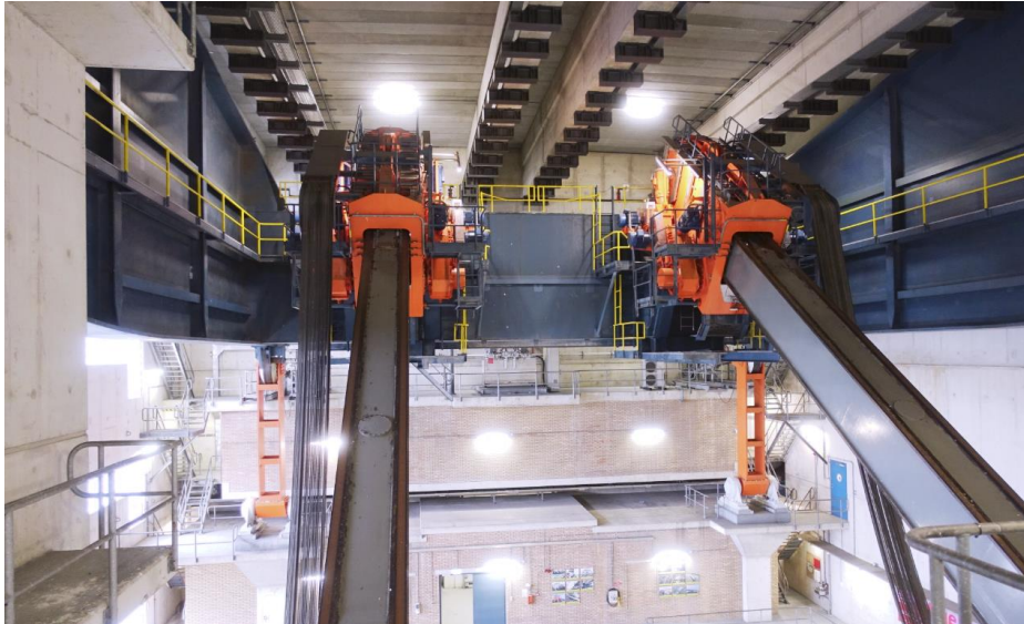
De twee elektromotoren die de klep over de heugelbanen trekken zijn aan de binnenzijde van het ballastblok bevestigd.
