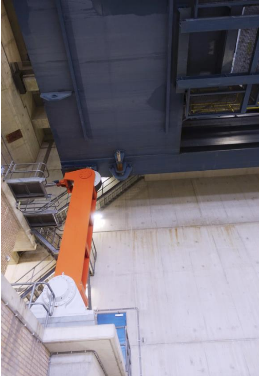
Zicht op een van de twee opzetstelten die onder het ballastblok zijn bevestigd en er voor zorgen dat de klep niet beweegt bij gesloten stand.
