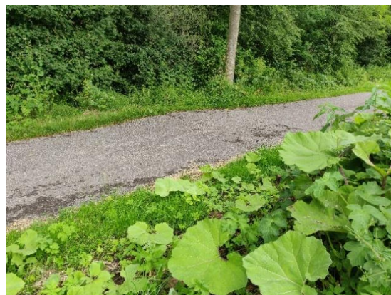
foto: fietspad met uitstroomduiker
