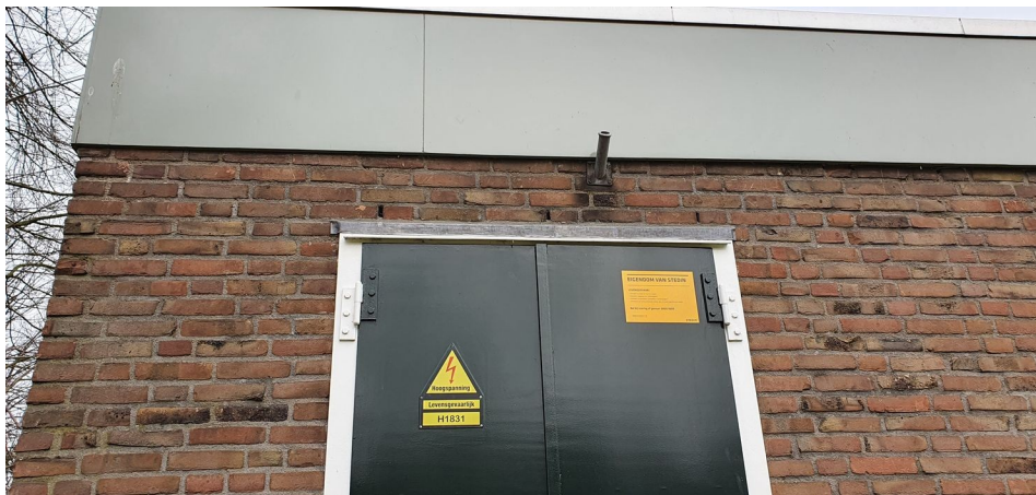
In de zuidelijke buitenmuur van het transformatorhuisje bevinden zich enkele open stootvoegen. Foto: K. de Vries | Ecoresult B.V.
