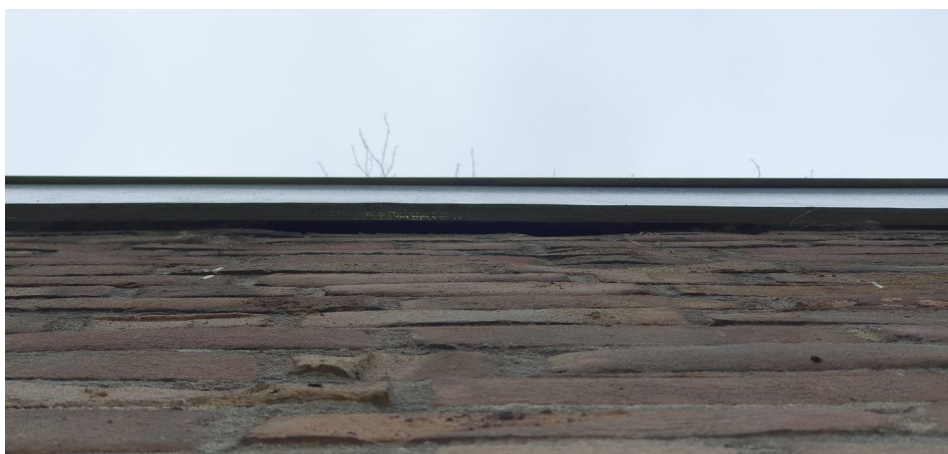
Tussen de boeiboord dakrand en de buitenmuren van het transformatorhuisje bevinden zich kieren. Foto: K. de Vries | Ecoresult B.V.
