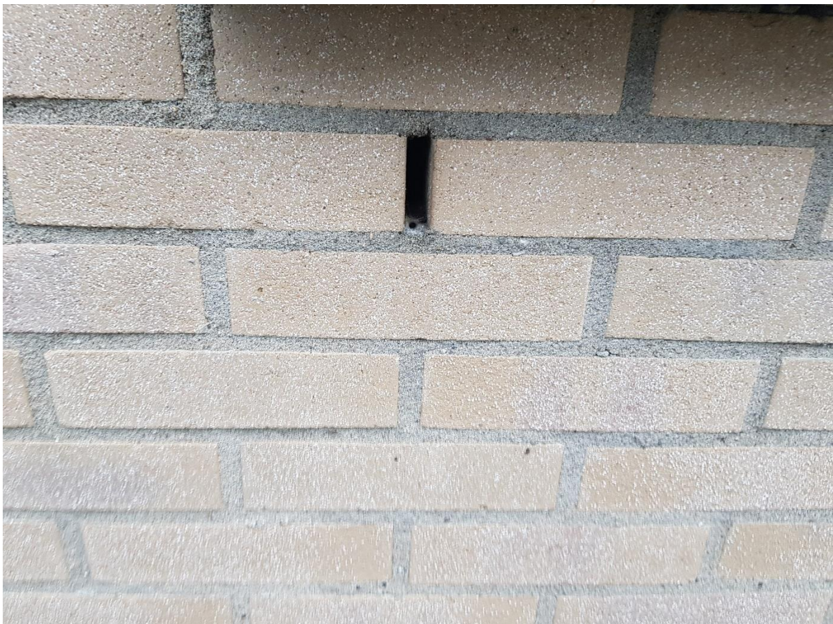
Figuur 4-1. Open stootvoegen in de gevels van de huidige bebouwing.
