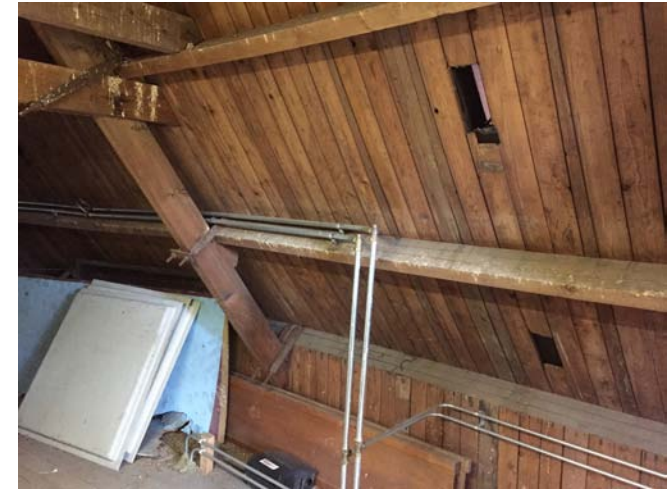
foto vervuiling en roestige spantankers + ventilatiegaten
