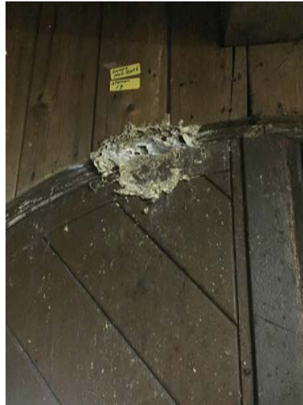
foto's binnenzijde kozijn nr 3 vervuild en roestig H&S-werk
