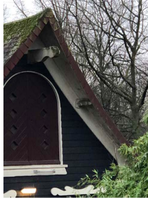
Foto topgevel, gordingen en beschot vervuild
