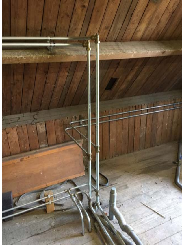
foto W-leidingen over vloer, wanden en gordingen
