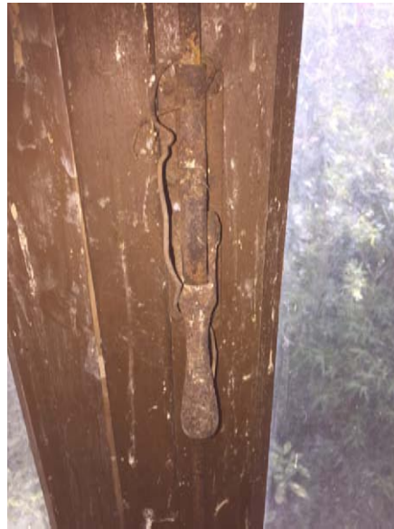
foto's binnenzijde kozijn nr 16 vervuild en roestig H&S-werk
