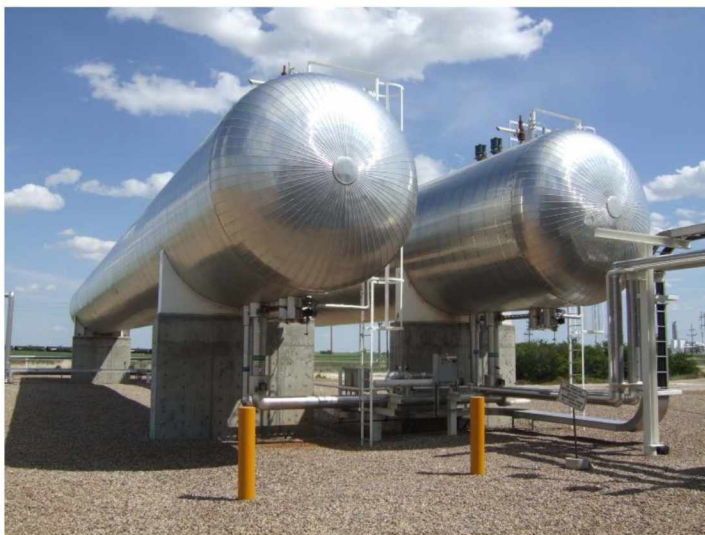
Figuur 4-5: Voorbeeld horizontale opslagtanks vloeibare CO 2
