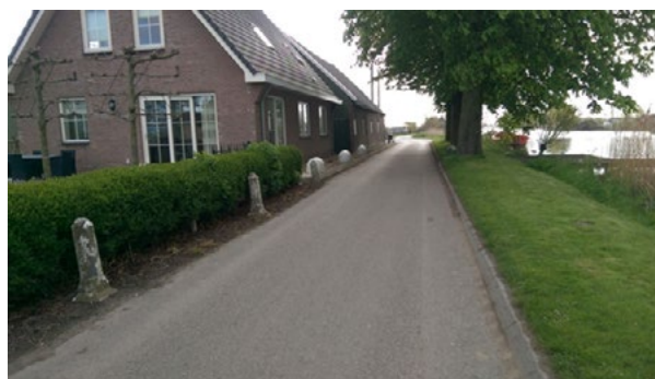
Figuur B4- 5 Op deze kering bevinden zich verschillende NWO'en, zoals bomen, huizen en wegverharding.. De aanwezigheid van deze objecten kan afdoen aan de stabiliteit van de kering.
