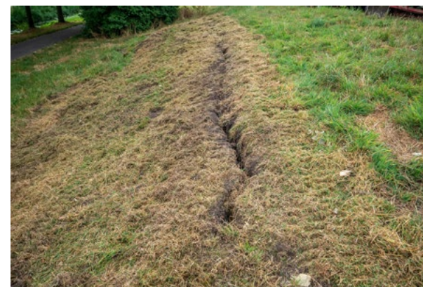
Figuur 3-2: Scheurvorming in de dijk tijdens de droge periode van 2018 in Alphen aan den Rijn
