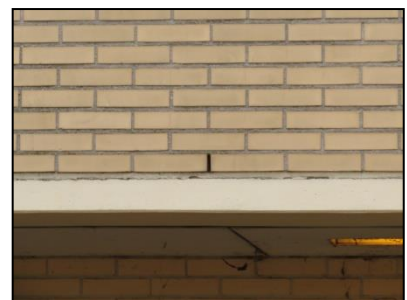
Figuur 5. Open stootvoeg mogelijke ingang voor vleermuizen.
