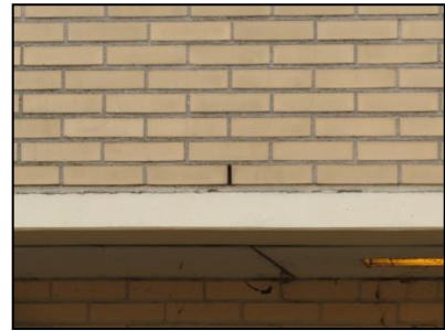
Figuur 5. Open stootvoeg mogelijke ingang voor vleermuizen.
